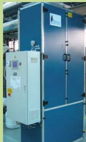
Diese Reisner-Anlage stellt kalte, trockene Luft bereit, um ein optimales Arbeitsklima für Spritzgießwerkzeuge zu schaffen.
