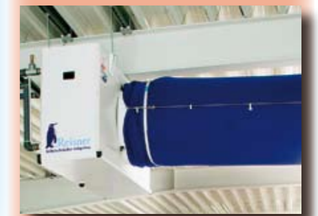
Diese Lüftungsanlage verteilt warme Luft, die nur durch die Abwärme der Kälteanlage temperiert wurde – Fremdenergieeinsatz nicht erforderlich.
